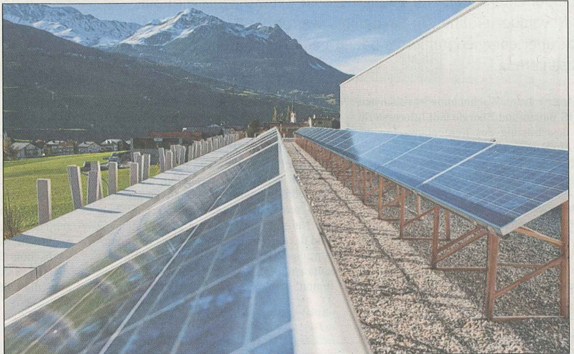
Auf dem Dach des Gebäudekubus produzieren rund 1200 Meter aneinandergereihte Solarpanels Strom.
